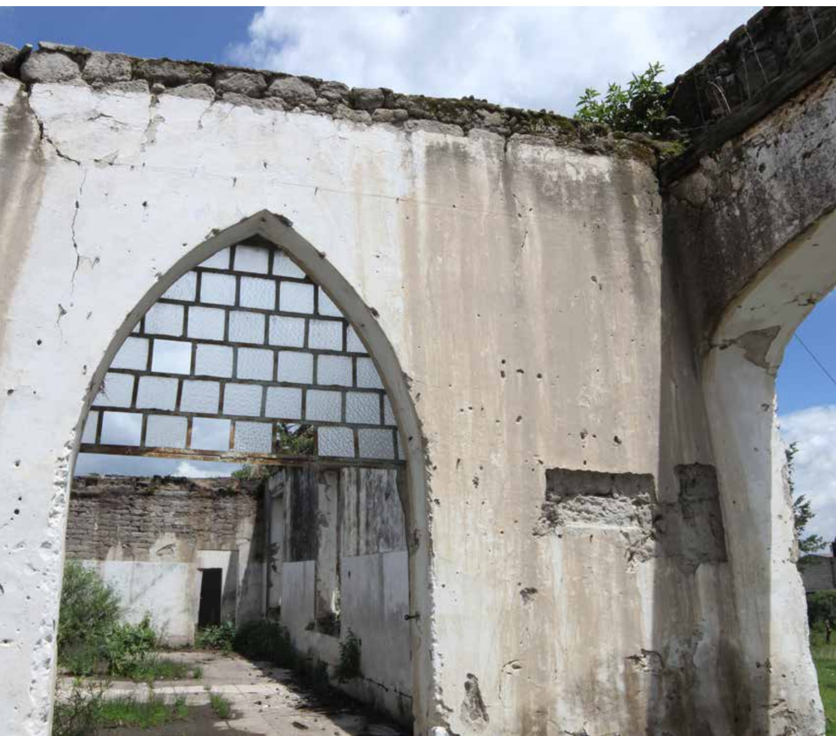
AÚN SE CONSRVA EN PIE PARTE DE LA CAPILLA DE SAN PEDRO ECATEPEC (FOTOGRAFÍA: NAZIM AVENDAÑO R.).
